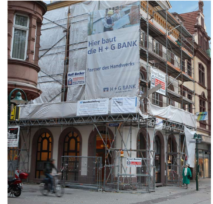
Bild 3: Ohne Ortsangabe – Die verunstaltende Wirkung soll besonders in bauhistorisch, städtebaulich oder touristisch bedeutsamen Umfeldern vermieden werden.
